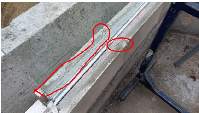
Fotografía n°5: Zona de rotura del peto.
